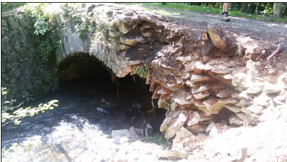
Stav mostu před opravou...
