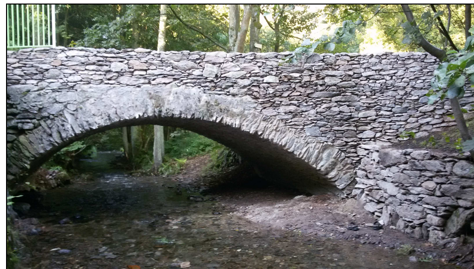
...a po opravě.
